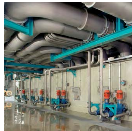
Водоотделитель с откачивающими насосами
