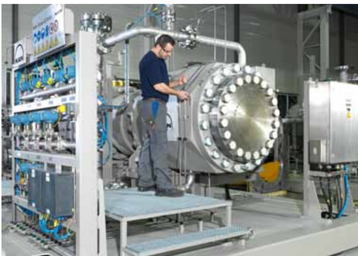
Полностью смонтированный магистральный компрессорный агрегат
